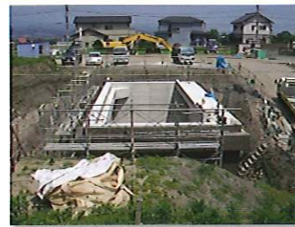
汚水処理施設
