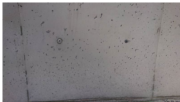
図-1 覆工コンクリートに発生したエアアバタ
