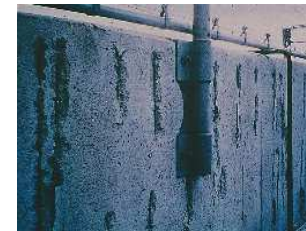
壁高欄のコンクリートはく落
