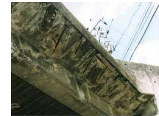
張出し床版下面の鉄筋露出
