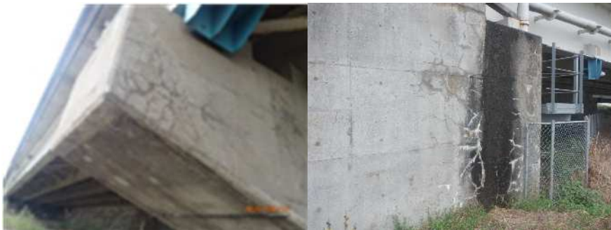
写真-1 A橋のひび割れ状況（左：P1橋脚，右：A2橋台）
