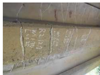
図 2 曲げひび割れ
