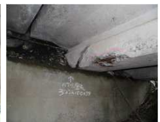
図 3 せん断ひび割れ
