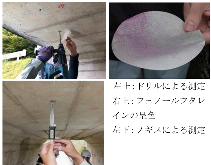
写真-1 中性化深さの測定方法
