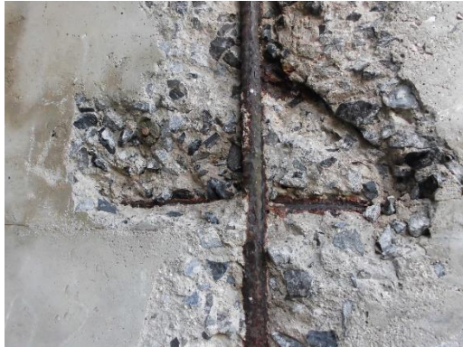
洗浄後の露出した鉄筋の状況
