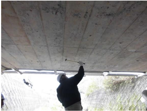
コンクリートの浮き状況の確認
