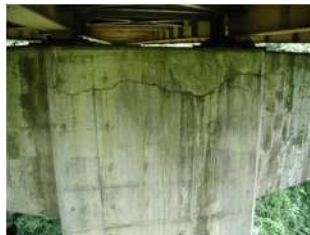
解図 2.4 ASR により劣化した橋梁の例
