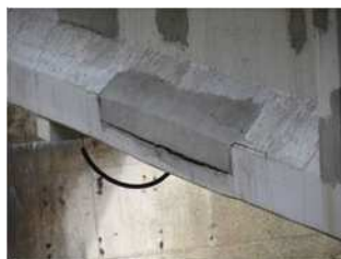
解図 2.5 マクロセル腐食により再劣化した断面修復部の例
