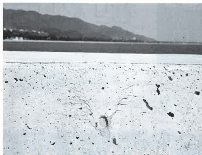
写真-1 型枠に生じた沈みひび割れ 8)
