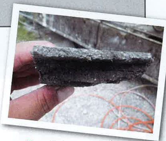
写真4 ■ 層間剥離を起こしたコンクリート片 (写真:コンクリートメンテナンス協会)
