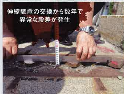
図3 ■ 点検や補修で重大な損傷が見逃されることも
