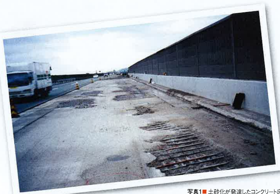
写真1 ■ 土砂化が発達したコンクリート床版 (写真:国土技術政策総合研究所)
